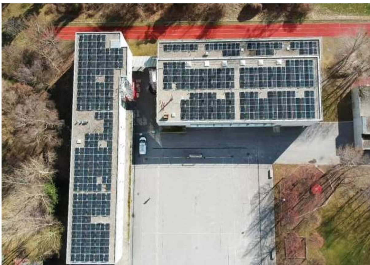
Ein Blick auf die neue Photovoltaikanlage auf dem Schulhaus.
